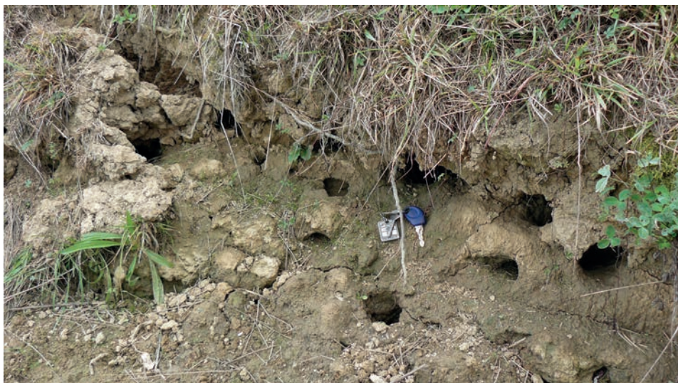
Fig. 32 - Una breve porzione di sponda di uno stagno presso cascina Italia trivelata da numerose gallerie; nella parte sinistra dell'immagine si nota il crollo dell'argine a causa della vicinanza di queste cavità.
